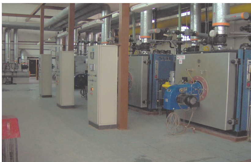
Technologické zařízení kotelny OKD na ul. Čs. armády
