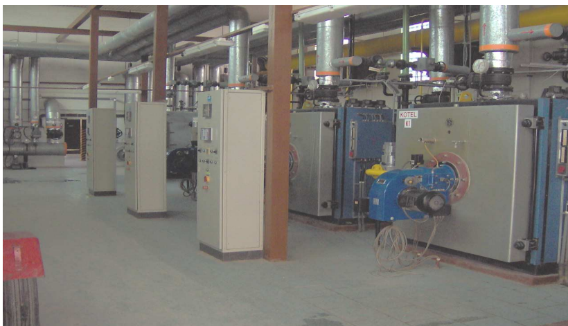
Technologické zařízení kotelny OKD na ul. Čs. armády
